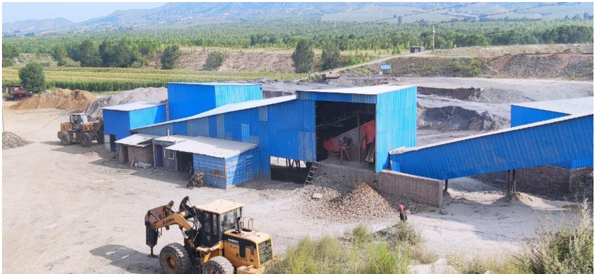
现有工程破碎生产线
